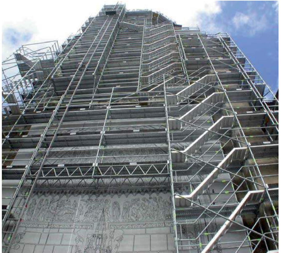
▲ Acceso por escalera adosada al andamio
