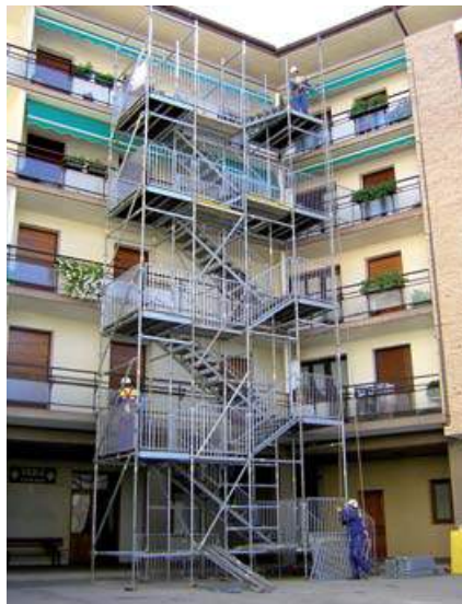
▲ Escaleras de andamios para acceso a viviendas
